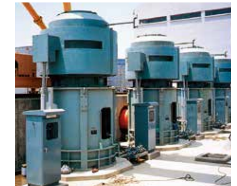
Vaporizing pumps in LNG Plant, Korea (Size:1,000mm, Driver:650kW)
